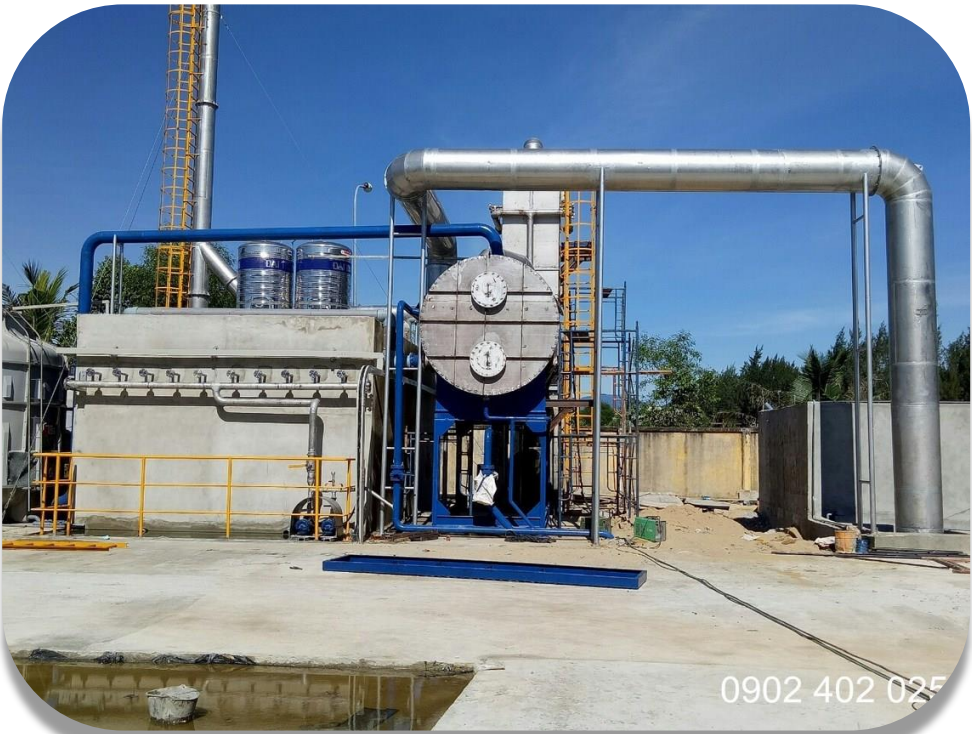
Hệ thống xử lý mùi cho Dây chuyền bột cá, bột tôm
