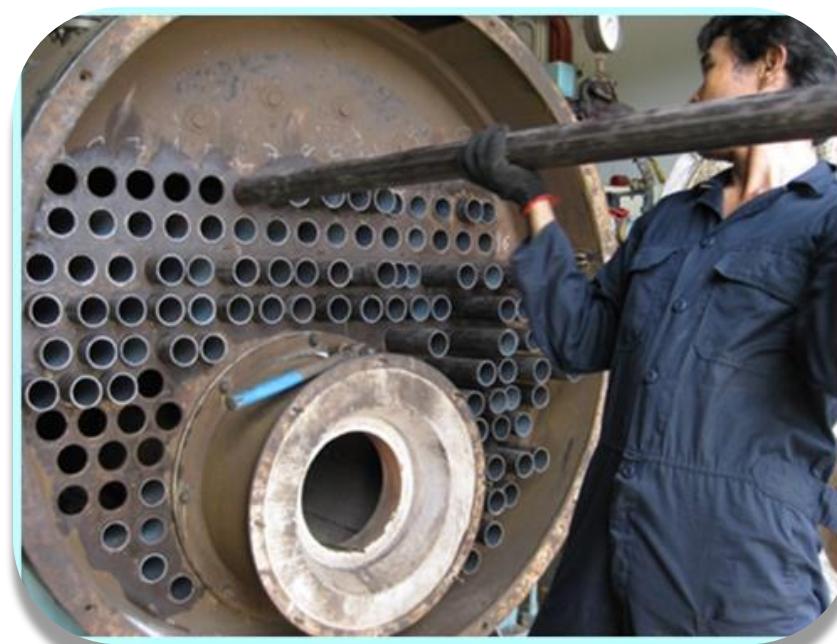
Bảo trì lò hơi ống lửa
