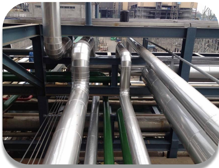
Đường ống hơi, nước, khí
